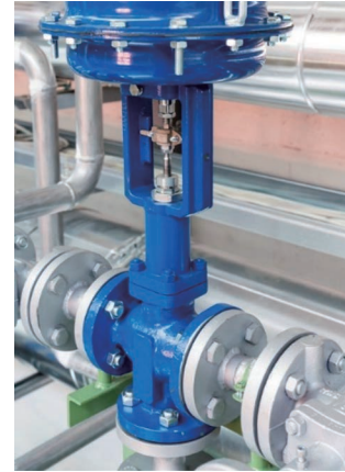
그림6 현장에 설치된 밸브의 예
